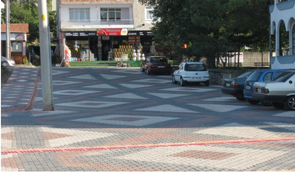
Barbaros Mah.27.sokak ile Pınar Cad arası (Kaymakamlık Arkası Yolda Prefabrik bina önü) kaldırım çalışması tamamlanmış hali
